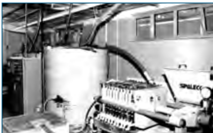
Abwasseraufbereitung Ochistnye sooruzheniya
